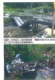
【田沼・宮前地区】上流河川橋樑、橋脚が流されたため通行止め、現在は仮設橋中。
